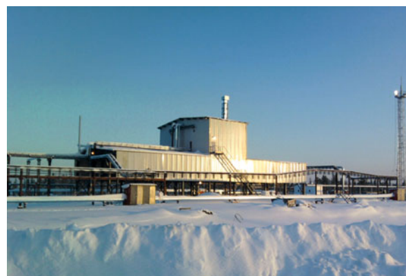
Bild 2. On-Spot-Gaskondensat-Verladeanlage (ausgelegt für 2 x 32 Kesselwagen).
