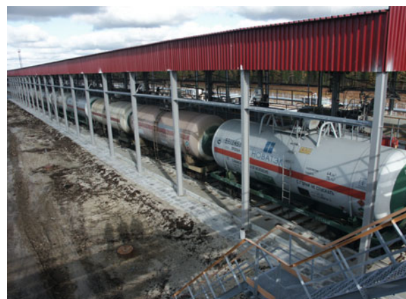
Bild 1. Flüssiggas-Verladeanlage (ausgelegt für 2 x 10 Kesselwagen).
