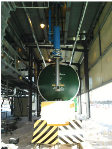
Bild 3. On-Spot- Anlage mit Befüllrohr.
