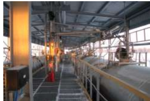
LPG Belade- und Entladesystemen
